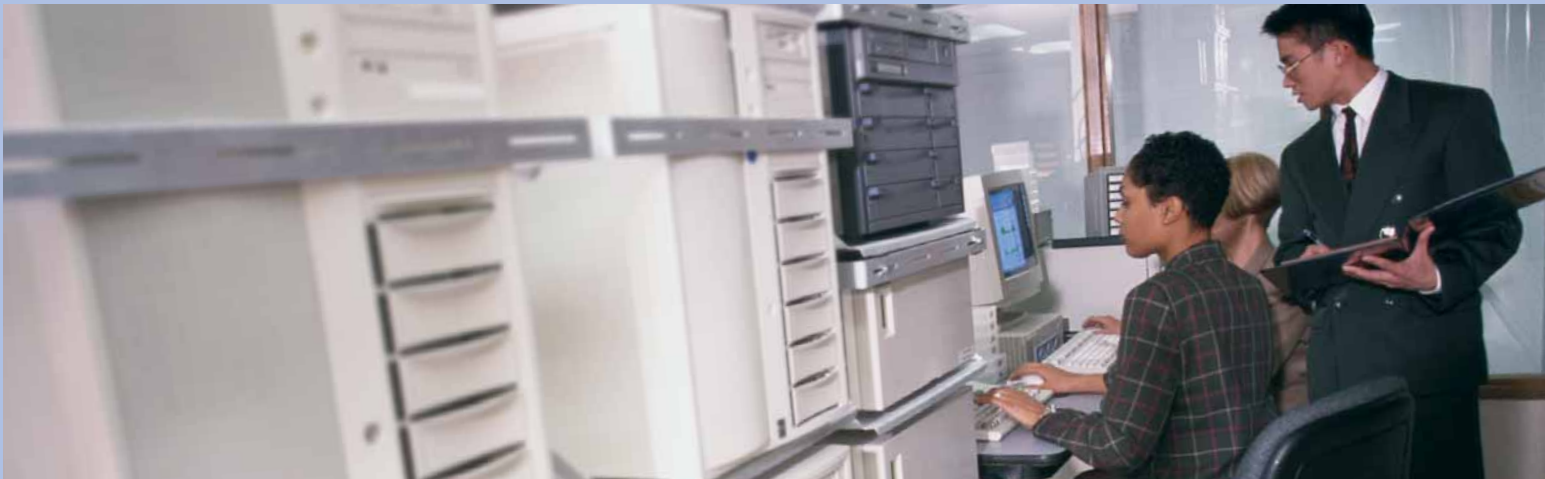
Centro de datos: Aplicación de seguidilla
